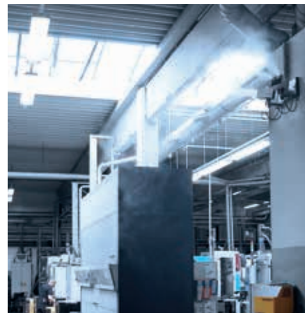
Hochdruck-Luftbefeuchter DRAABE TurboFog im Produktionsbereich
