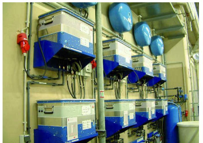
Der halbjährliche automatische Austausch der DRAABE Service-Container sichert Betriebssicherheit und Hygiene
