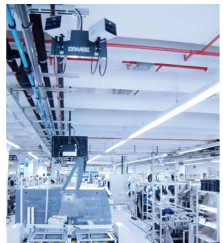
ESD-Schutz: DRAABE TurboFog Vernebler sorgen für eine konstant optimale Luftfeuchte in der Fertigung
