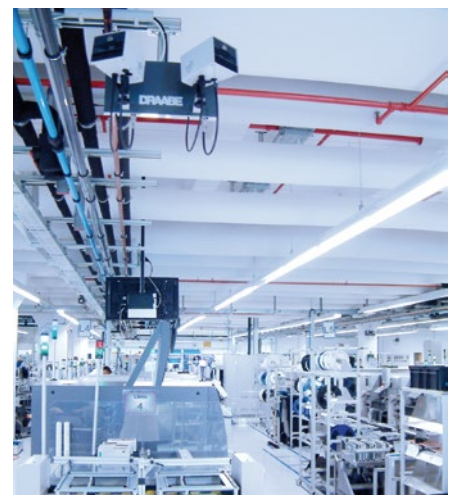
ESD-Schutz: DRAABE TurboFog Vernebler sorgen für eine konstant optimale Luftfeuchte in der Fertigung
